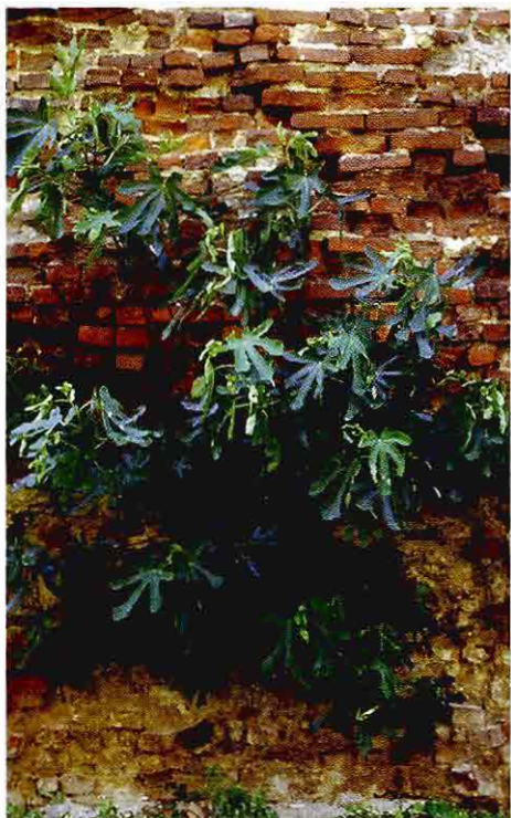
Foto 5 Un esemplare di fico ( Ficus carica ) insediato sopra un tratto di muro già notevolmente dissestato.
