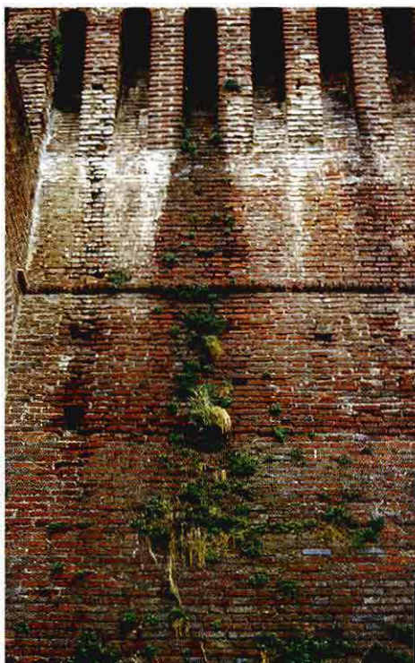
Foto 4 Dove vi sono percolazioni di acqua c'è un notevole aumento quantitativo e qualitativo della vegetazione.
