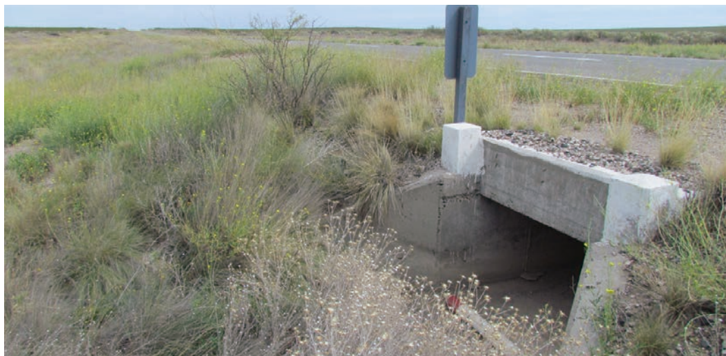
Figura 8 - Vista de la alcantarilla donde se halló un nido de Golondrina Tijerita ( Hirundo rustica erythrogaster ). 25 km al este del Embalse Casa de Piedra, RN 152, prog. 263. Dpto. Curacó. La Pampa. Argentina. 24 de marzo 2016. Foto: M. Bianchini. (Ver B en Figura 13).
